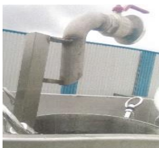
Figuur 5: Vulling sprinklertank/voorraadtank
