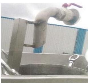
Figuur 5: Vulling sprinklertank/voorraadtank
